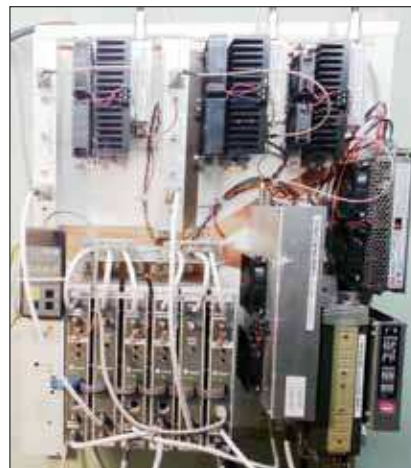
Figure 3: Transpondeurs linéaires de HB9TV-2 sur les hauts de Lausanne [Photo: HB9DUG]
